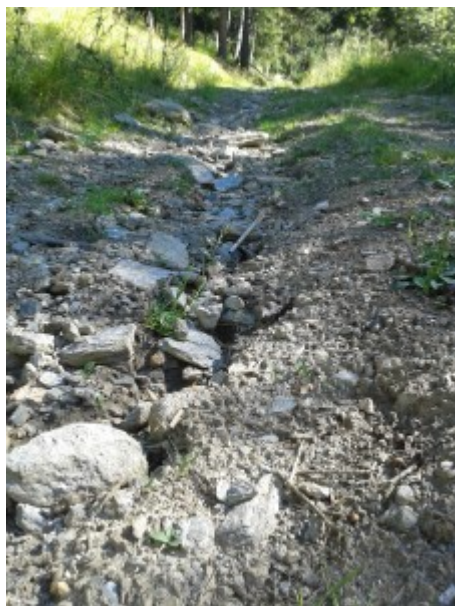
Il lavoro di erosione dell'acqua.
